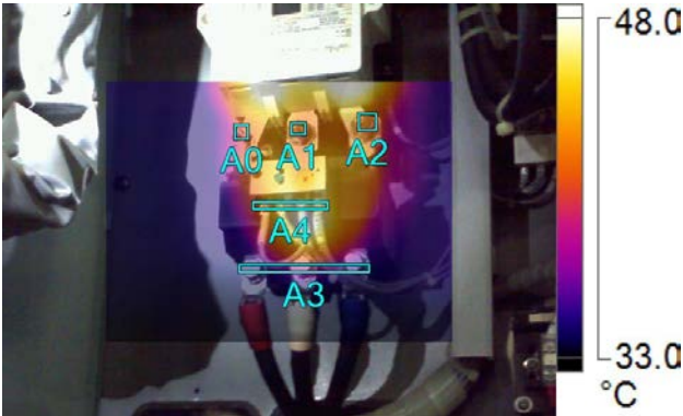
IR005151.IS2-No2 Main LO pump
