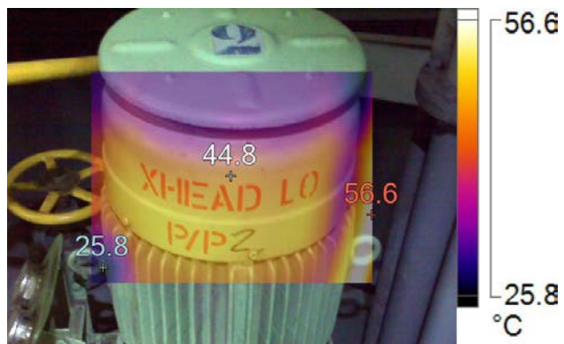
IR005238.IS2-No2 Crosshead LO pump 12/3/2016 2:49:19 PM
