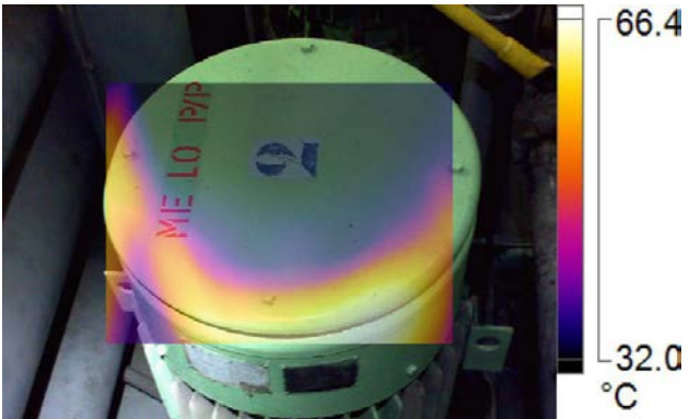
IR005157.IS2-No2 Main LO pump
