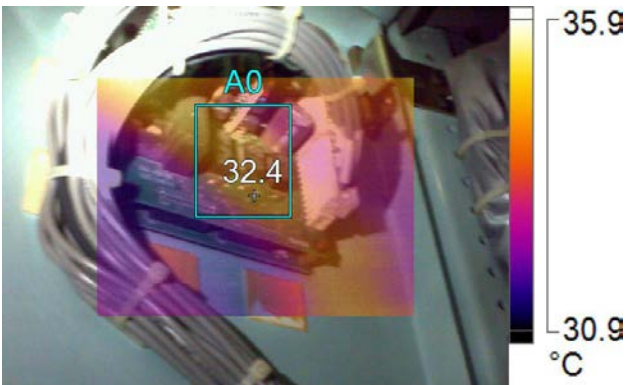
IR005155.IS2-No2 Main LO pump
