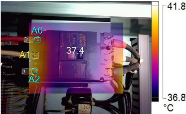
IR005115.IS2- No1 Aux Blower panel
