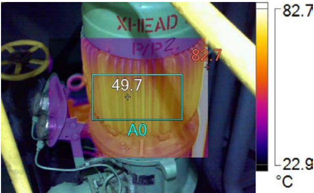
IR005239.IS2-No2 Crosshead LO pump 12/3/2016 2:49:49 PM
