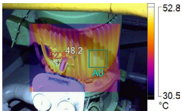
IR005240.IS2-No2 Crosshead LO pump 12/3/2016 2:50:01 PM
