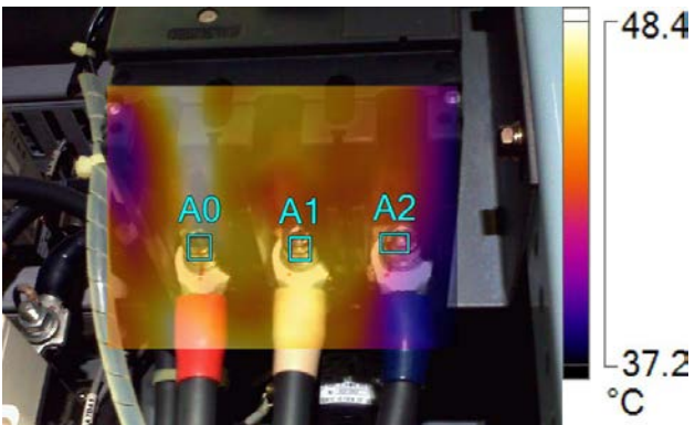
IR005150.IS2-No2 Main LO pump
