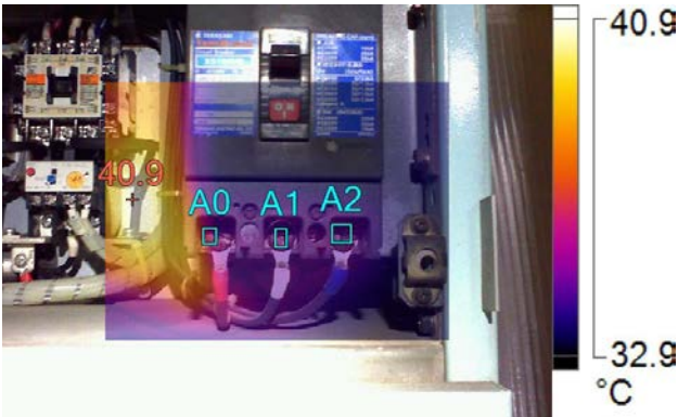
IR005971.IS2-No 2 Pump room fan
