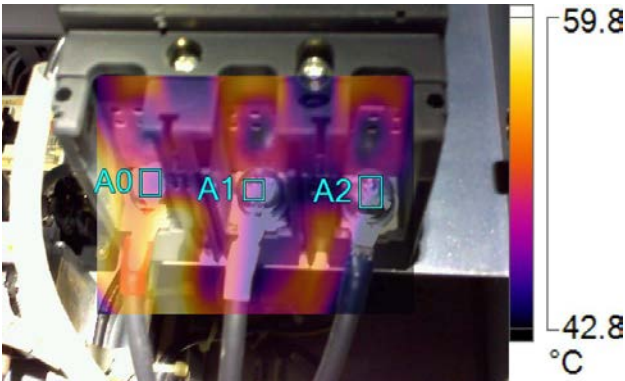
IR005710.IS2-No3 ER vent fan 12/4/2016 9:28:21 PM
