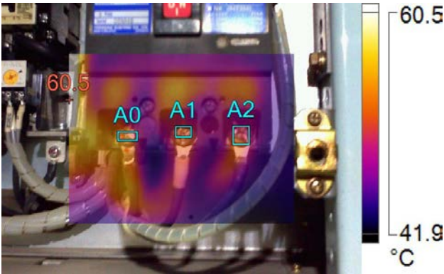
IR005717.IS2-No 1 ER vent fan
