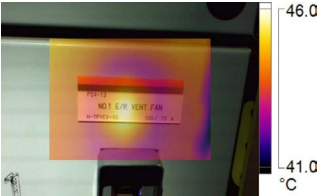
IR005714.IS2-No 1 ER vent fan
