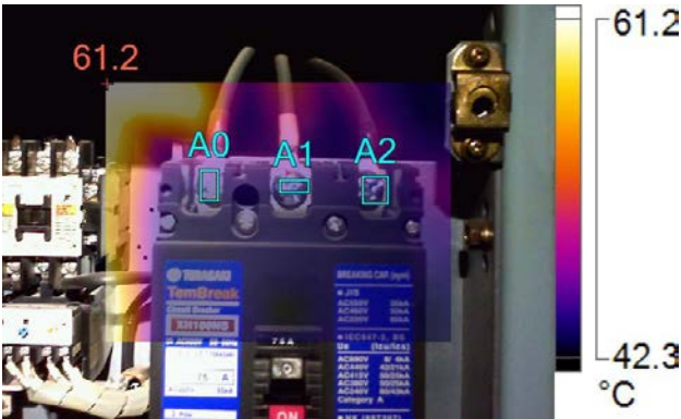
IR005709.IS2-No3 ER vent fan 12/4/2016 9:27:52 PM
